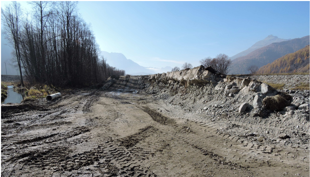
Hier steht noch ein Überrest des alten Damms und erlaubt einen Blick in dessen Aufbau. Die Bäume links im Bild bleiben von den Bauarbeiten unberührt und stehen schon bald im neuen Flussbett (26.10.18).
