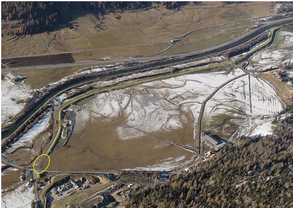
So präsentierte sich die Revitalisierungs-Baustelle am 18. November 2018. Nur noch ein kurzes Stück im obersten Bereich fehlt noch (gelber Kreis), dann hat der Damm (gelbe Linie) seine komplette Länge erreicht.
