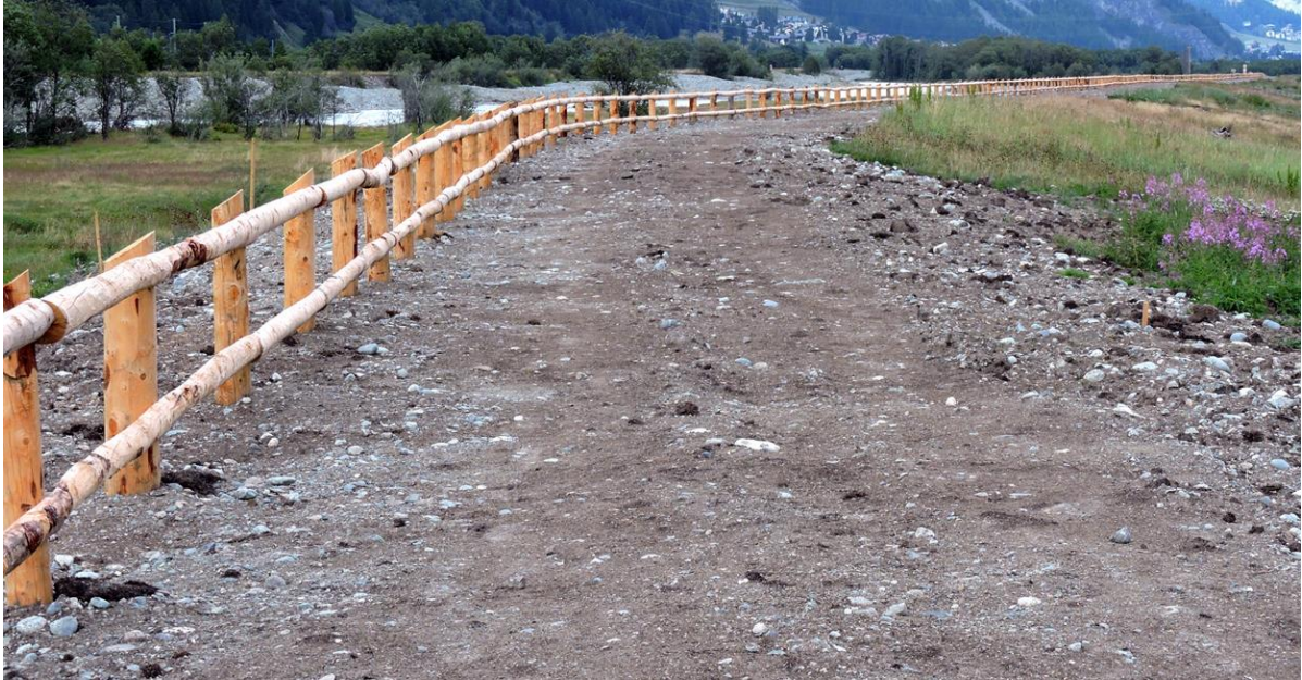
Der neue Weidezaun zielt die Dammkrone über eine Länge von rund 800 Metern (29.7.20).
