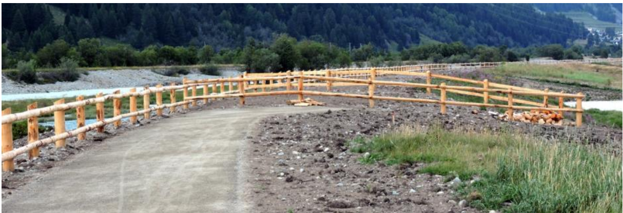
Der befestigte Weg und der Zaun führen die Wandernden und Radfahrenden an dieser Stelle sanft von der Dammkrone hinunter und via Hof Isellas auf den bestehenden Radweg (29.7.20).
